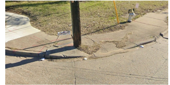
Rampas que no cumplen con las normas de accesibilidad
